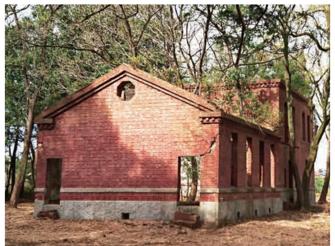
写真1 東側から見た西洋館外観。屋根は抜け落ち、度重なる地震などの影響か、レンガ壁の一部には亀裂が入りはじめている。
